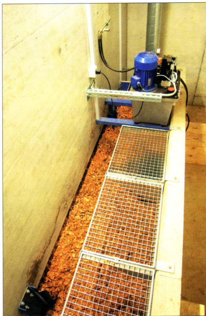
Le silo d'alimentation, avec son système classique de vérins hydrauliques.
