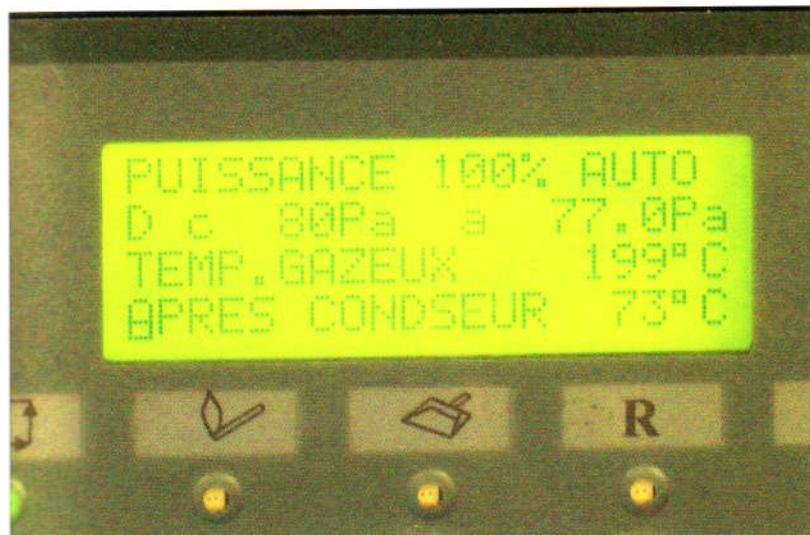
Armoire de commande (détail).
